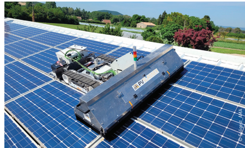
Des outils comme, ce scanner robotisé développé par la société Soligest, sont utilisés pour détecter les moindres défauts des panneaux.
